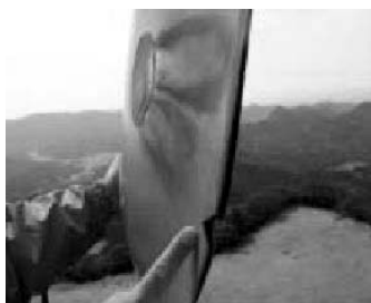
レセプタ(丸い部分)に落雷した跡。ブレードの接合部に剥れがあるが、補修で対応できる（隠岐大峰山風力発電所 2006）
