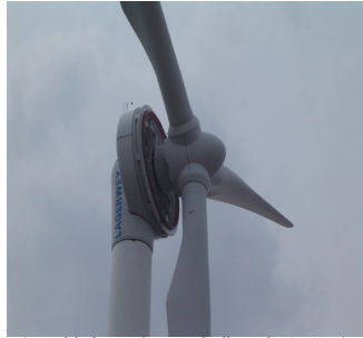
台風被害を受けた大豊風力発電所
