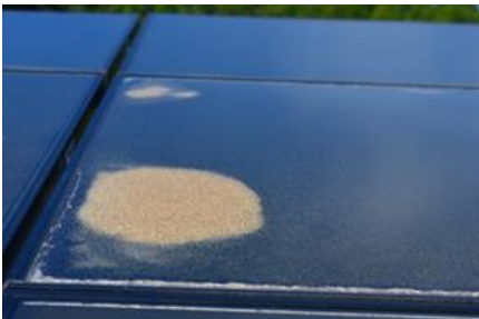
パネルの破損状況
