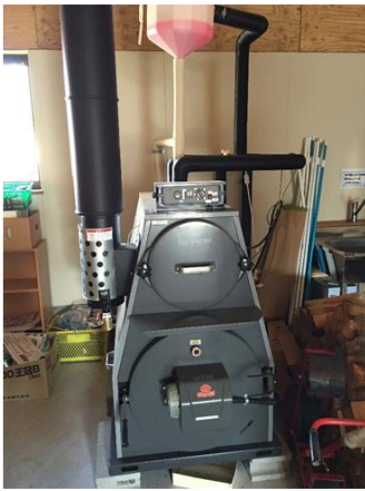
【薪ボイラー 間伐材や廃材などを利用、床暖房にも使
